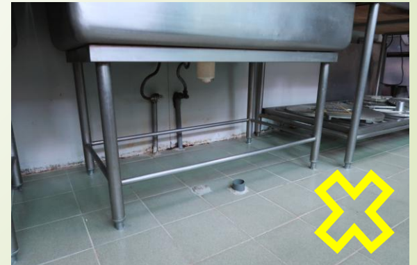
水槽下 缺排水管
