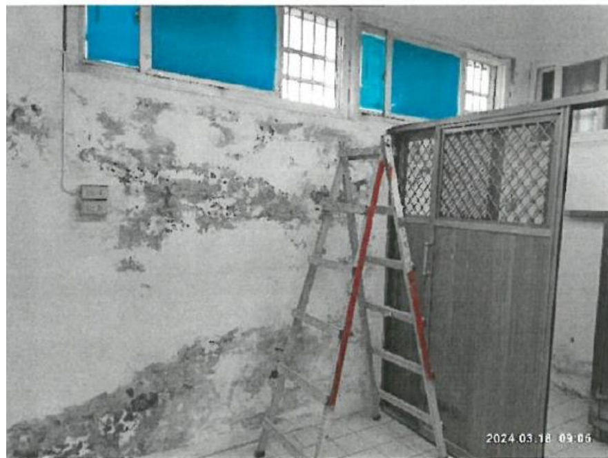
乾貨室牆壁壁癌
