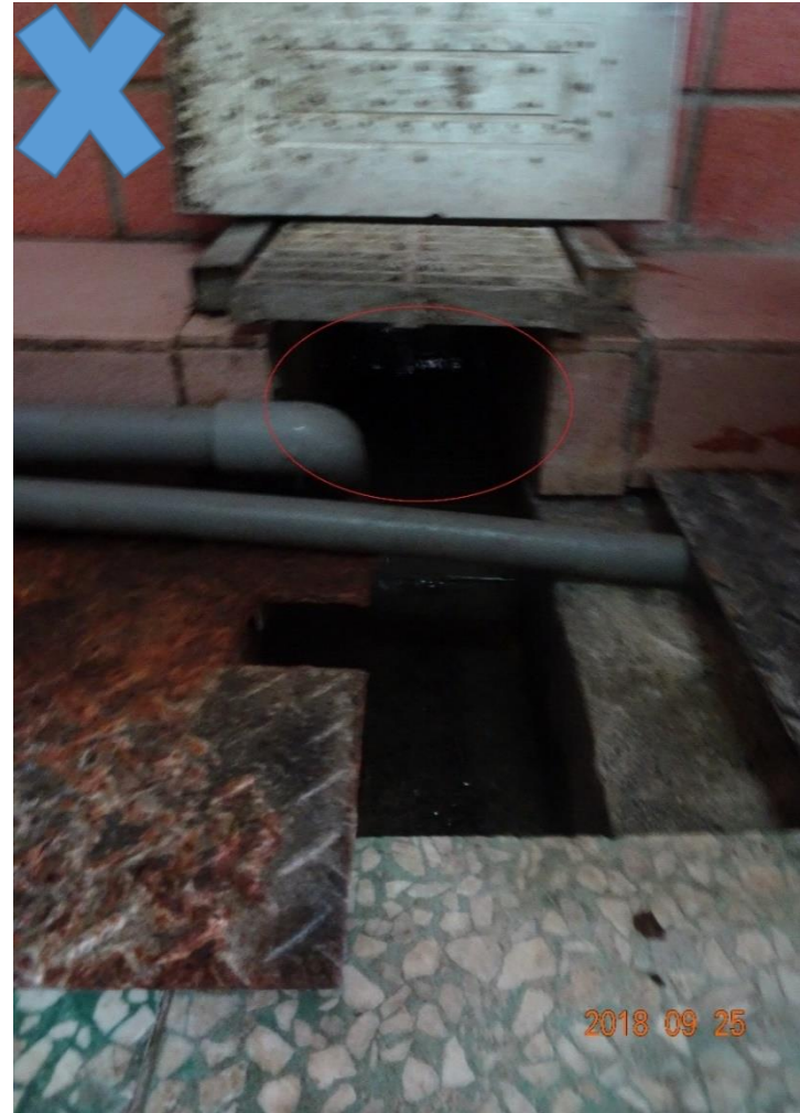
對外排水溝無柵欄防止病媒侵入
